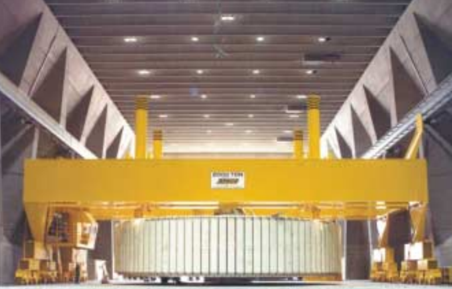
2000 Ton Gantry Crane, USA
